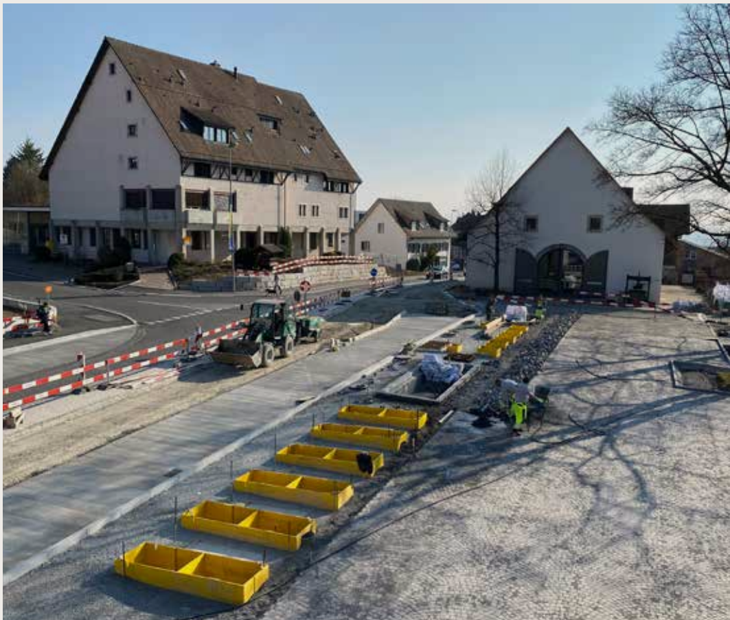
Foto: Nachmittagsstimmung auf der Baustelle Gemeindehausplatz/Ringstrasse, Stand Mitte März 2022 (Foto: Natascha Korstick)
